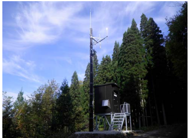
【写真 1 巢山雨量テレメータ観測所全景】
