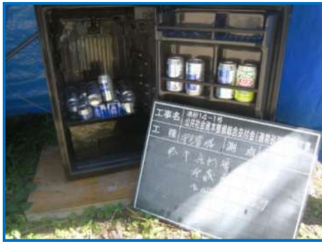
*水分補給用冷蔵庫の設置
