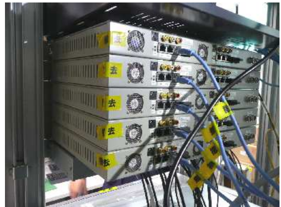
写真2. 機器と配線の識別標示状況
