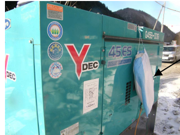
防油堤内臓型発電機
