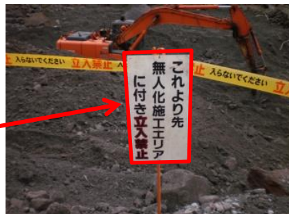
〔写真-6 立入禁止看板〕
