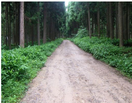
写真1. 雨水による路面浸食状況
