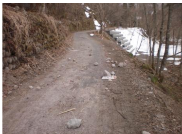
防護網設置前 落石状況
