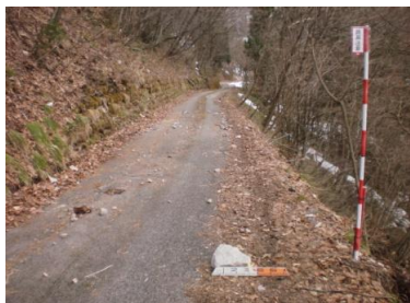
防護網設置前 落石状況
