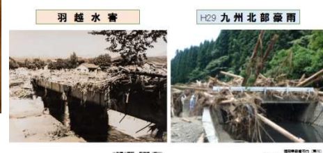
大量の流木が橋に引っかかり、河川の氾濫が発生しました。
