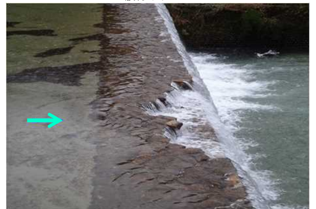
水通し天端摩耗状況
