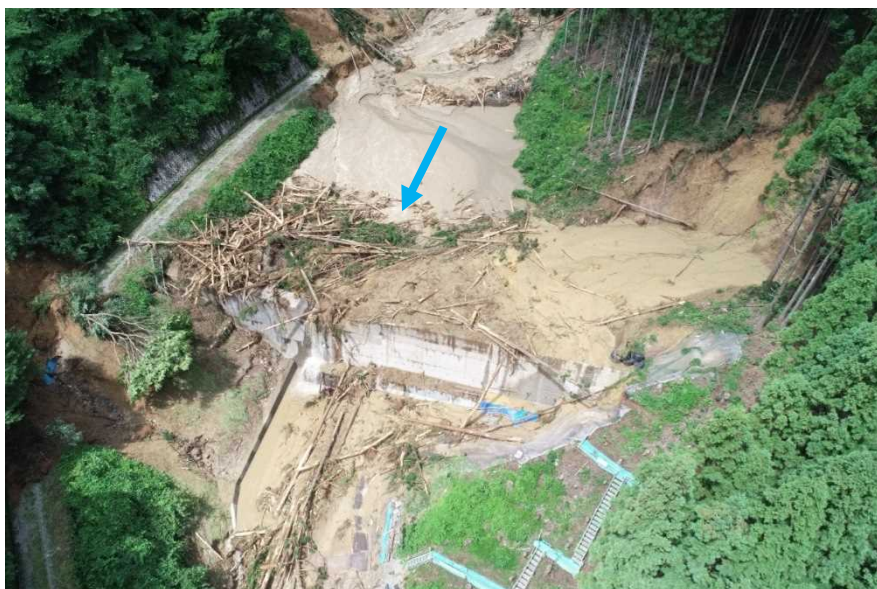
被災直後の状況(撮影: R4年8月)
