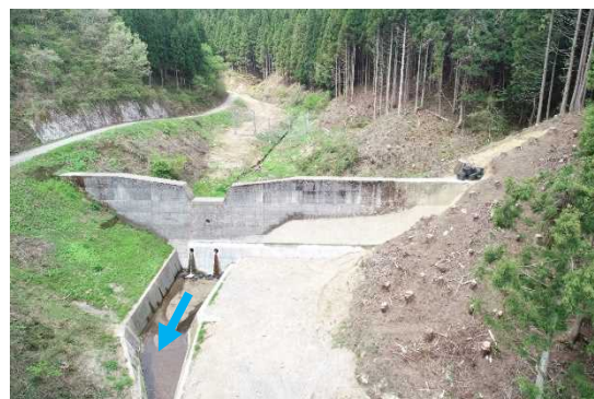
被災前の状況 (撮影: R4年6月)
