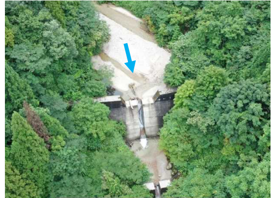
カラ木沢第2号砂防堰堤 土砂堆積状況
