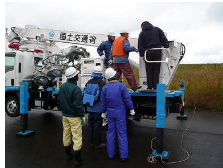
照明車を使った操作訓練
