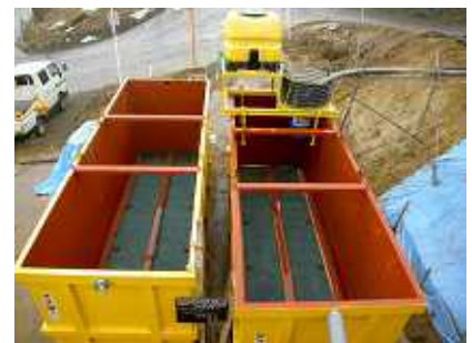
写真 - 2 脱水フィルター部
