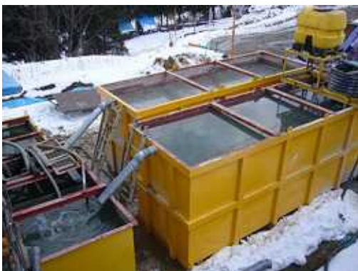
写真 - 4 システム稼働状況
