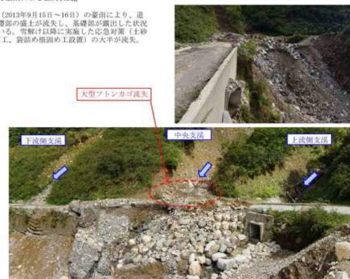
被災状況概観(2013.9.27撮影)
