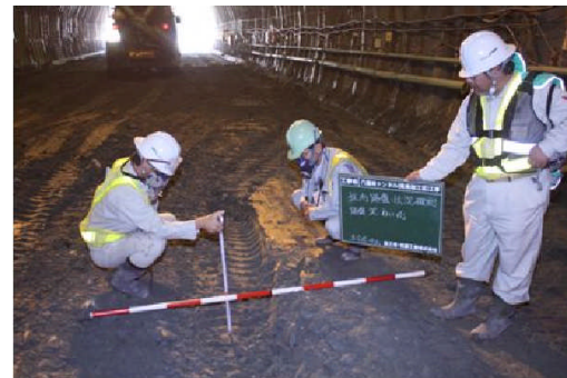
湧水による路盤泥濘化状況
