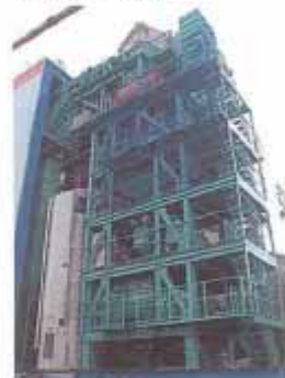
流動化処理土 製造プラント全景
