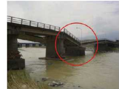
橋脚の洗掘・沈下
