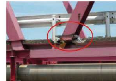
【橋梁の例】 斜材の破断
