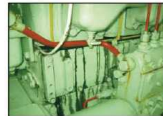
ポンプ原動機からのオイル漏れ
