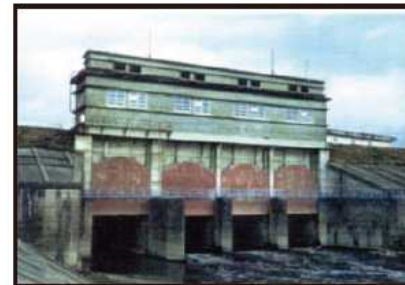
【河川構造物の例】 樋門の老朽化
