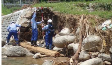
河川構造物の被害状況調査(添田町)
