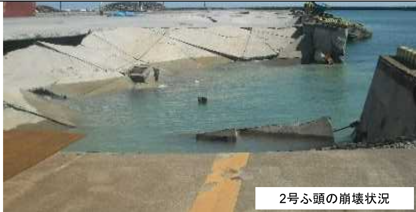
平成23年3月 東日本大震災時における被災状況(震度6弱)
