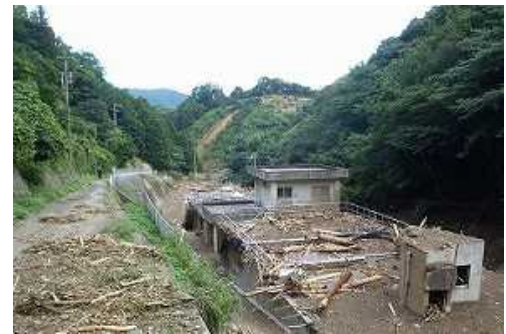
土石流により被災した南予水道企業団吉田浄水場 (愛媛県宇和島市)
