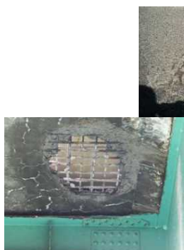
(床版下面) 床版の抜け落ち
