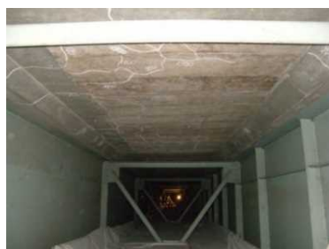
ひび割れの発生
