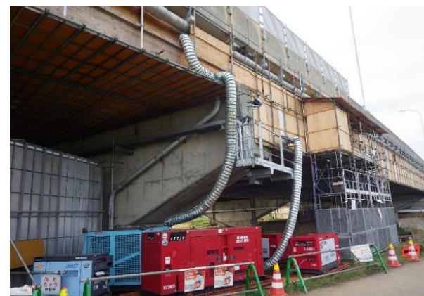
コンプレッサーを使用した空調設備
