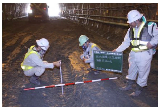
湧水による路盤泥濘化状況
