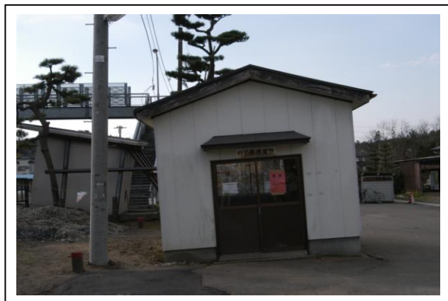
①建物の沈下・転倒
