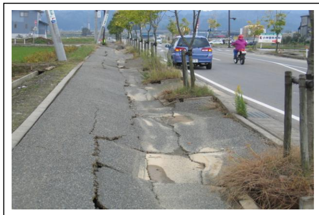
③歩道部の地盤沈下
