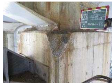
【橋脚頭部のコンクリート欠損状況】
