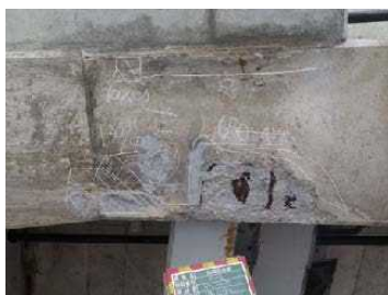
【主桁中間部のコンクリート欠損状況】
