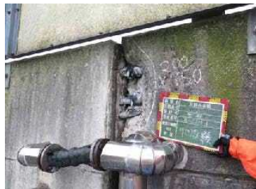
【主桁端部のコンクリート欠損状況】
