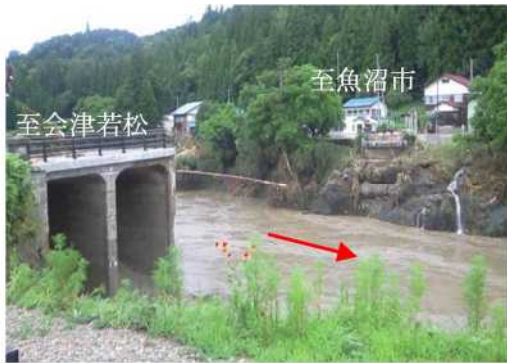
落橋後の状況
