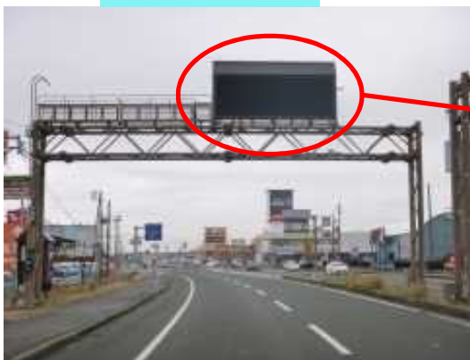
福山 道路情報板(取替後)
