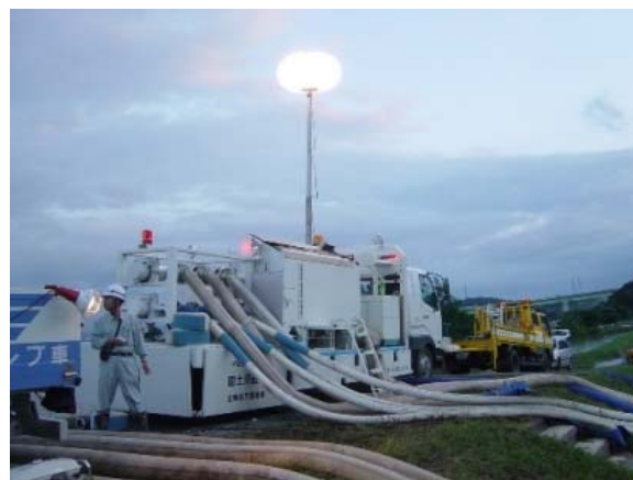
▲排水ポンプ車、照明車
