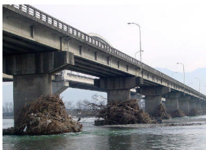
図-4 洪水後、橋脚に引っ掛かる流木
