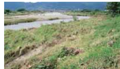
はん濫危険水位を超過する洪水によって掘削地が冠水(2007年9月)
