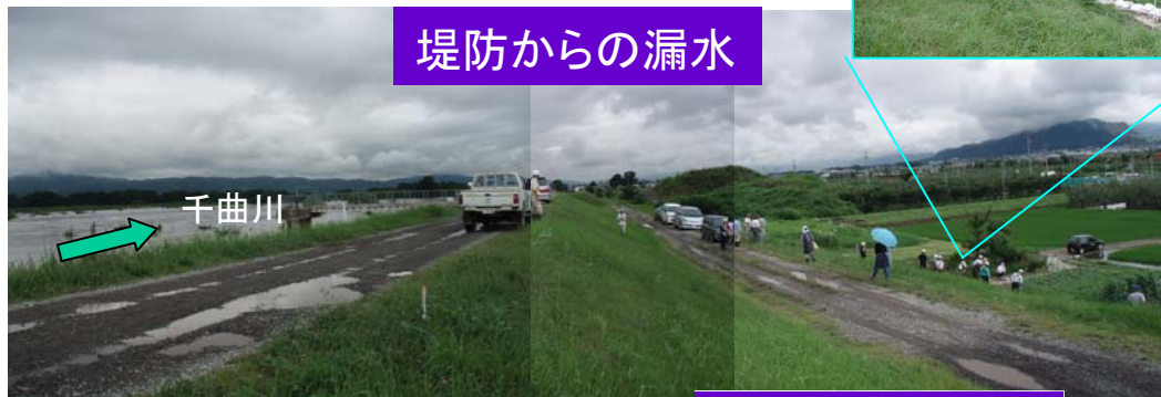
平成18年7月梅雨前線出水 漏水箇所 (千曲川:長野県 須坂市村山地先)
