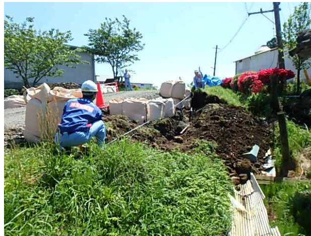
【金沢河国班】 阿蘇市 | 市道被災状況調査
