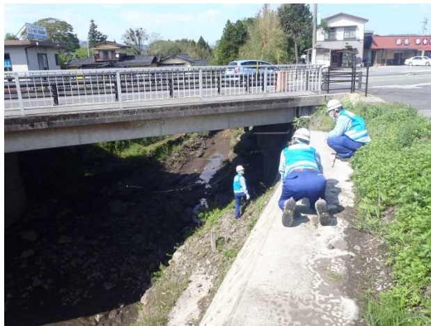
【富山河国班】 阿蘇市 | 国道57号 被災状況調査
