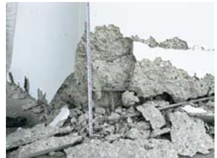
写真3-5-4 P7橋脚の被災状況その1
