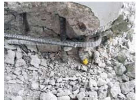
写真3-5-5 P7橋脚の被災状況その2
