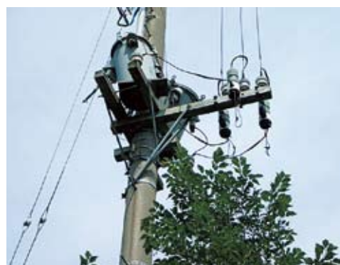
写真2-5-7 柱上トランスの傾き
