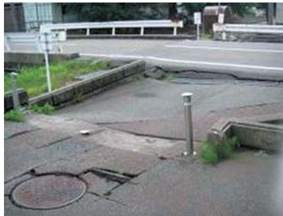
写真2-4-2 舗装のひび割れ・陥没
