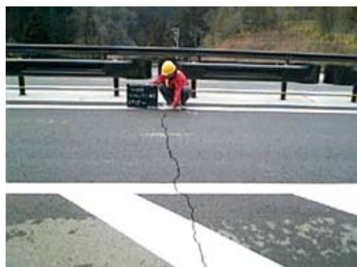
写真2-1-1 国道470号穴水道路 路面亀裂
