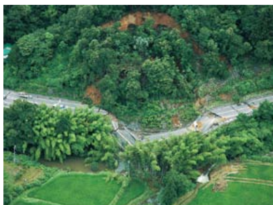
写真2-2-1 道路崩壊(国道8号長岡市大積千本町)
