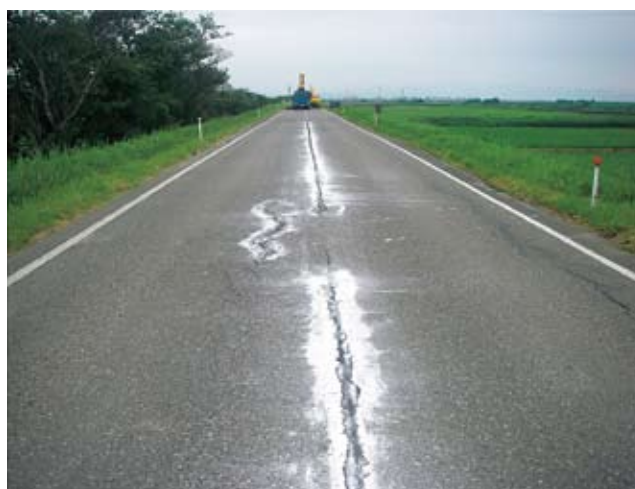
写真2-1-4 地震直後の堤防上面の亀裂
