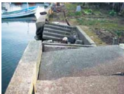
写真 3-9-6 穴水港（乙ヶ崎地区）海岸護岸破損状況
