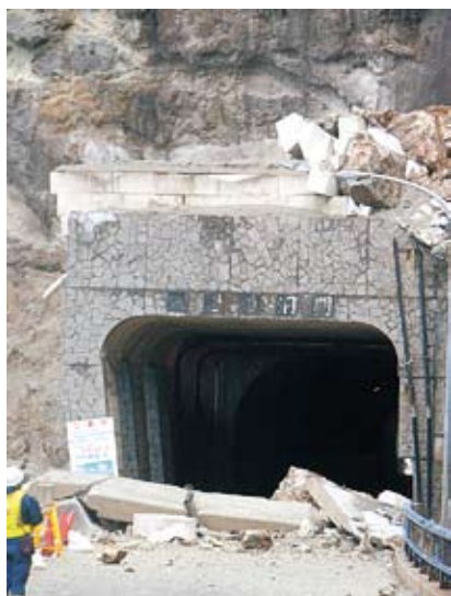
写真2-1-3 国道249号八世乃洞門 岩盤崩落
