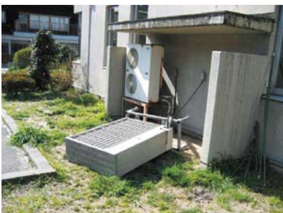
写真2-3-4 室外機の転倒
