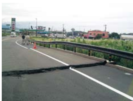
写真2-2-5 路面段差(豊田橋)
