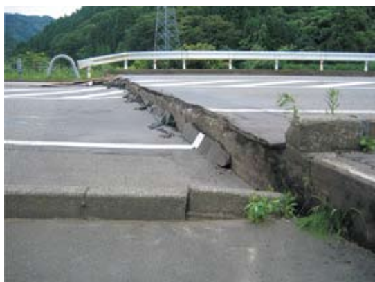
写真2-2-29 被災状況(藤掛川橋)
