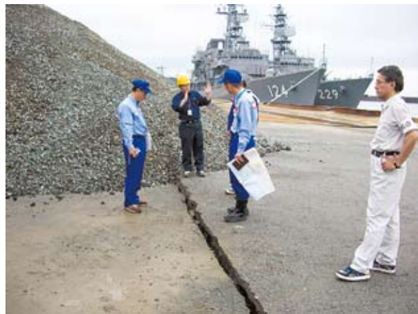
写真3-13-1 柏崎港の被災状況調査
