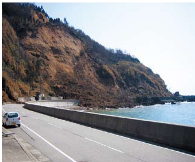
写真2-1-4 輪島市道 道下深見線 法面崩落
