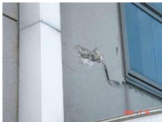
写真2-3-2 展望台 (外壁の一部損傷)
