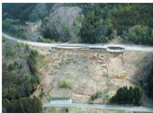
写真3-8-1 徳田大津IC～横田IC間の被災状況
