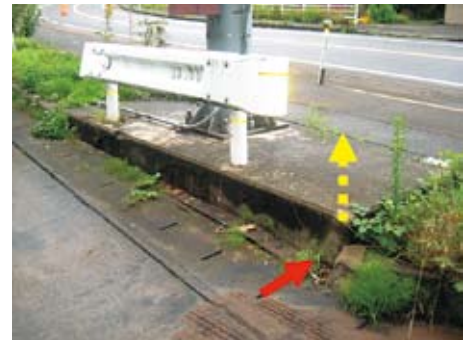
写真2-5-14 国道8号「曾地」道路情報板被災状況（基礎部分が浮き上がり支柱が傾斜した）
