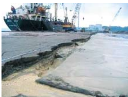
写真 3-9-1 七尾港（大田地区）野積場沈下状況
