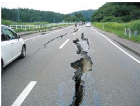
写真2-2-9 路面亀裂(柏崎市西山町坂田)
