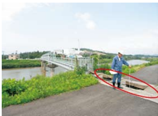
写真3-6-1 水道管周辺の堤体の沈下状況
