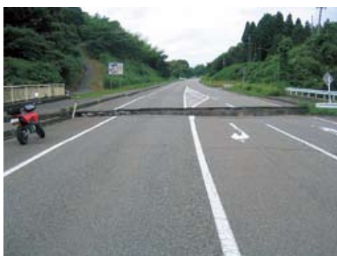
写真2-2-11 路面段差(田沢川橋)
