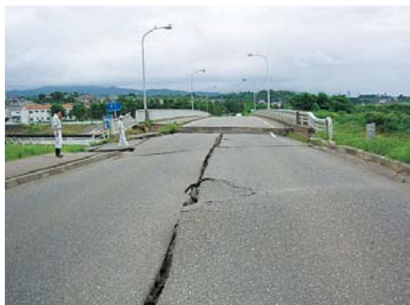
写真3-14-8 臨港八坂橋橋梁取付部段差発生状況
