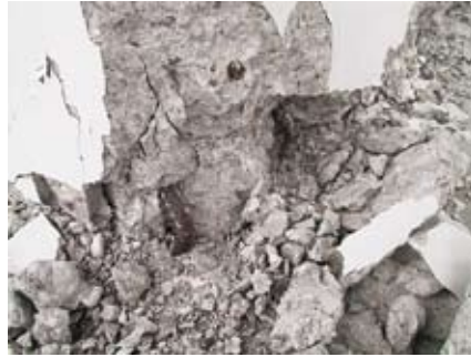
写真3-5-3 P6橋脚の被災状況その2
