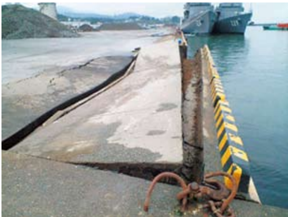
写真3-14-5 中浜埠頭 3号岸壁東側端部 取付護岸前倒状況
