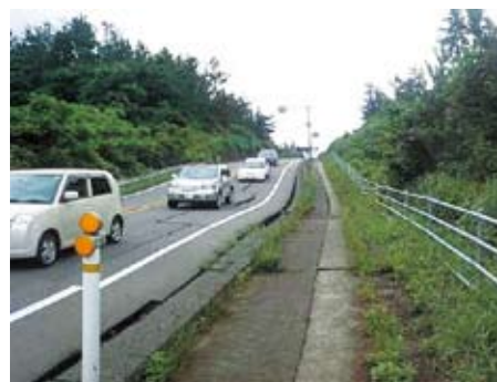
写真2-2-8 路肩亀裂(上越市柿崎区柿崎)
