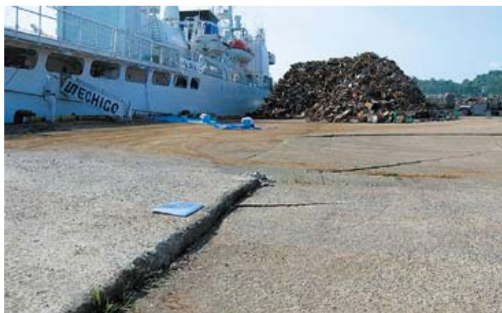
写真3-14-10 東埠頭岸壁エプロン部陥没状況
