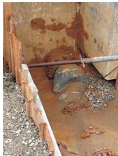
写真2-3-19 八坂中継ポンプ場の被災状況
