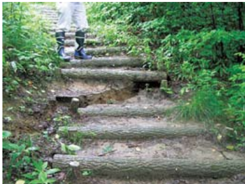
写真2-3-7 自然探勝路(亀裂)
