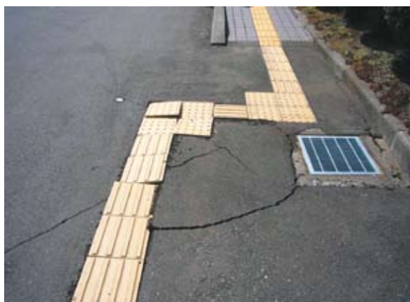
写真2-3-5 舗装のひび割れ
