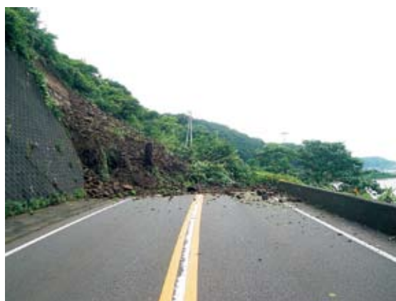
写真2-2-2 法面崩落(国道8号上越市長浜)
