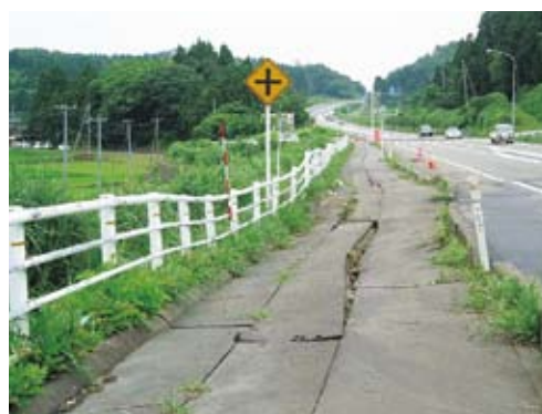
写真2-2-12 歩道沈下(柏崎市西山町別山)
