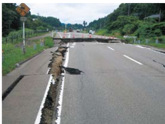
写真2-2-33 被災状況(柏崎市西山町尾野内)
