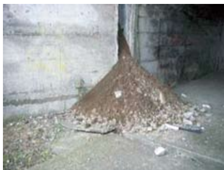
写真4-3-5 橋台と取付擁壁に生じたすき間からの土砂流出
