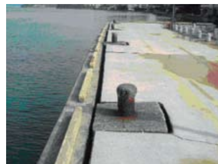
写真 3-9-4 和倉港物揚場本体前傾状況
