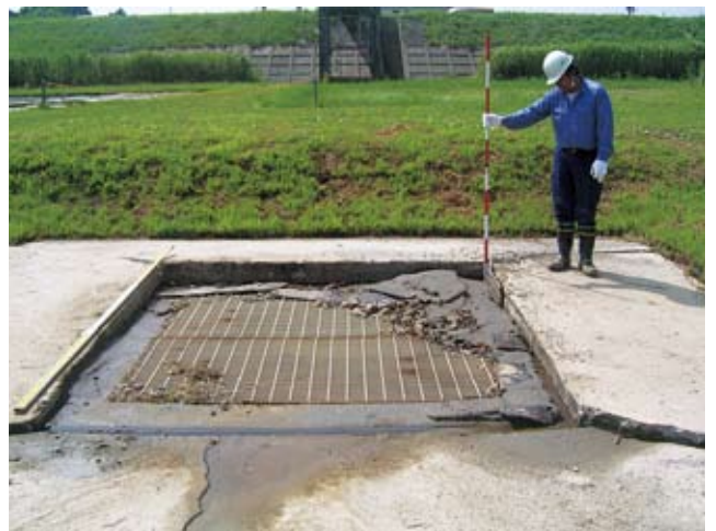
写真2-1-6 沈下・噴砂跡
