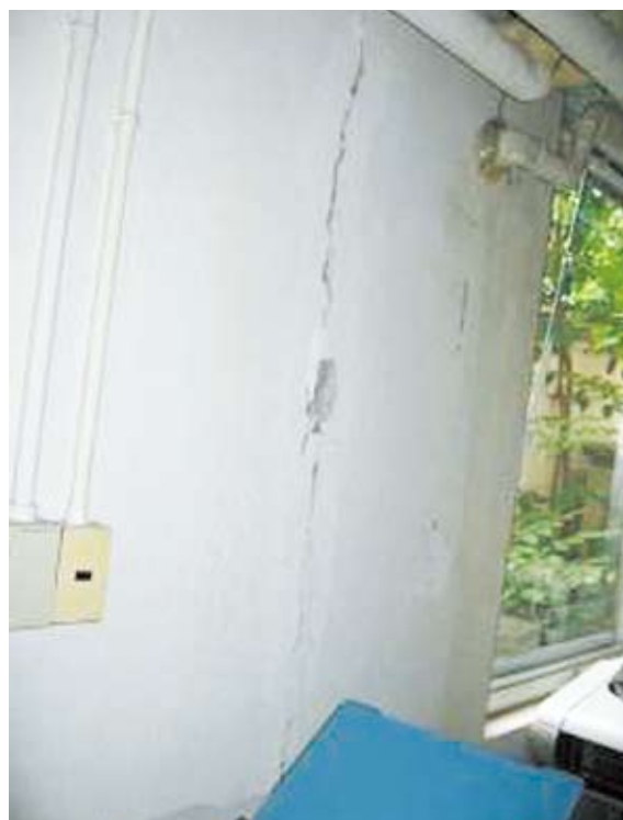
写真2-4-4 内壁のひび割れ
