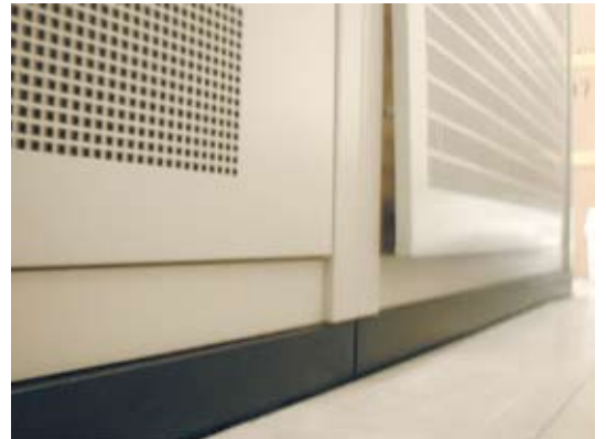
写真2-5-2 レーダ送受信装置の背面扉外れ
