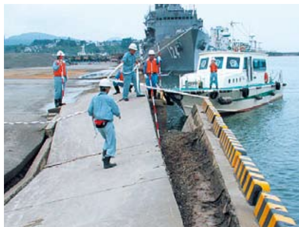
写真3-13-3 柏崎港の被災状況調査(その2)
