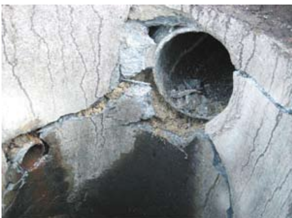
写真2-3-6 排水樹の破損
