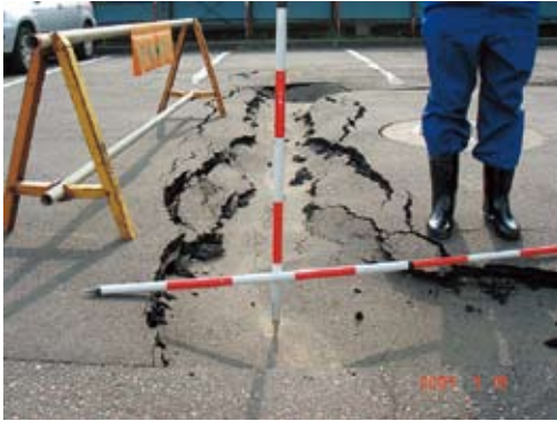
写真2-3-11 駅前公園 (舗装沈下)
