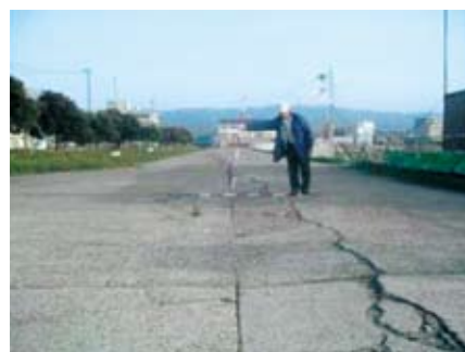
写真 3-9-2 七尾港（矢田新地区）臨港道路段差状況
