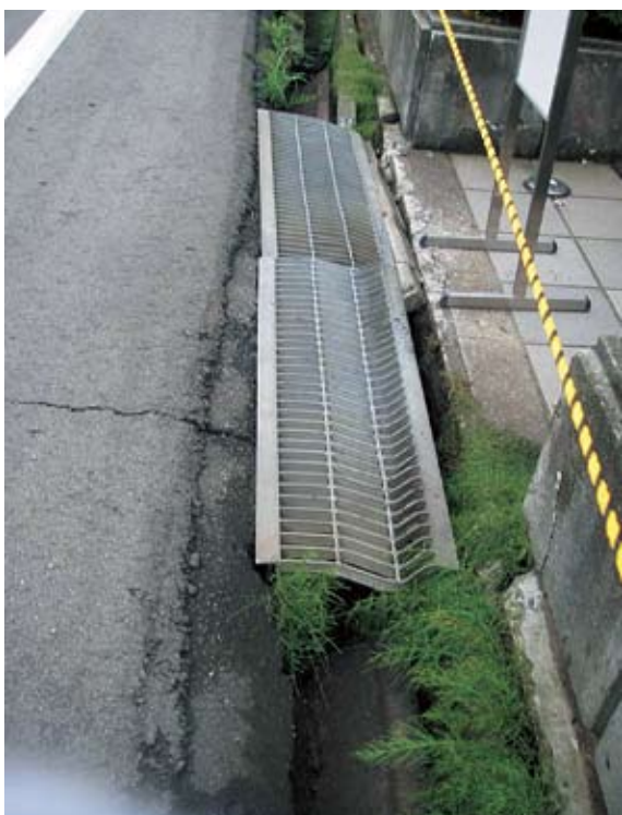
写真2-4-3 排水溝の破損
