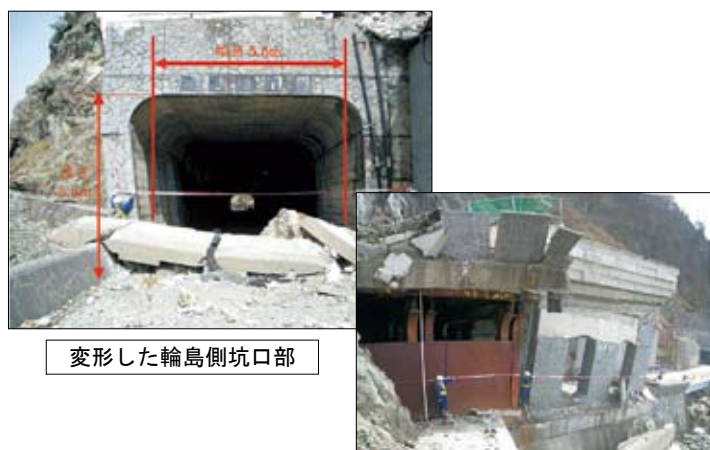
写真3-8-7 八世乃洞門被災状況その2
