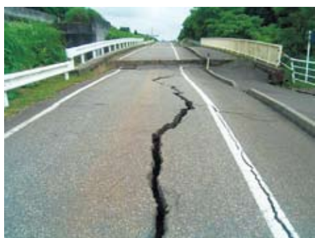
写真4-3-15 荒谷高架橋オフランプ部に生じた段差・亀裂
