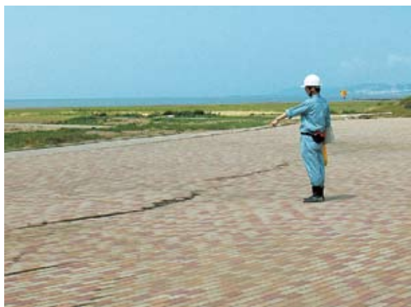
写真3-14-9 柏崎みなとまち海浜公園インターロッキング波状被災状況
