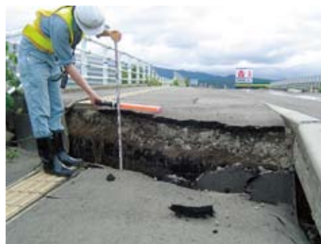
写真4-3-6 歩道に生じた段差
