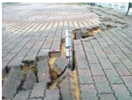
写真 3-9-5 和倉港野積場沈下状況
