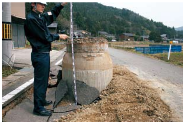
写真2-2-14 マンホールの隆起(輪島市田村地区)
