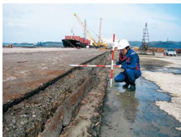
岸壁背後沈下状況(H19. 3. 29技調撮影) 1号→2号
