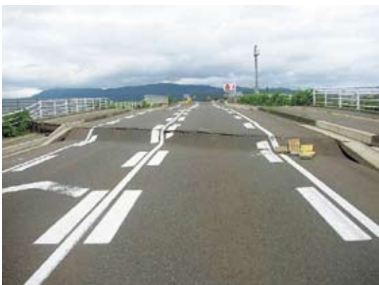
写真2-2-25 被災状況(比角跨線橋)
