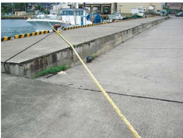
写真3-14-7 中央埠頭物揚場エプロン陥没状況
