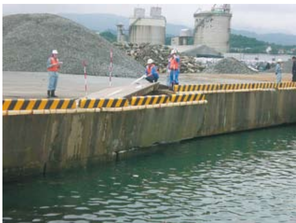
写真3-13-2 柏崎港の被災状況調査(その1)
