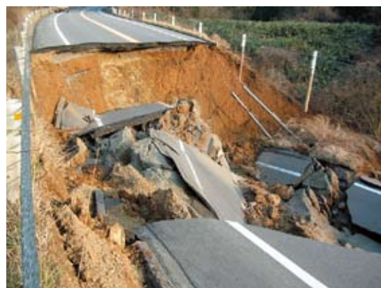
写真6-2-3 能登有料道路の被災状況
