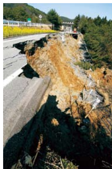
写真2-1-2 能登有料道路 横田IC 道路崩壊
