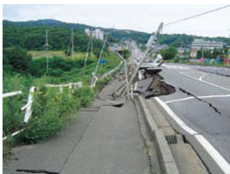
写真2-2-7 路肩・歩道崩壊(柏崎市鯨波)
