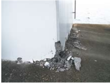
写真3-5-2 P6橋脚の被災状況その1
