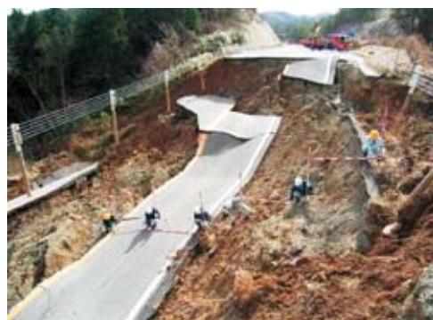
写真3-8-2 別所SA～越の原IC間の被災状況
