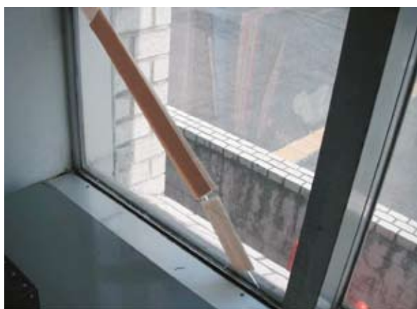
写真2-3-3 窓ガラスのひび割れ
