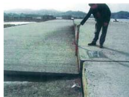
写真 3-9-7 輪島港（河合地区）岸壁（水深7.5m）エブロン沈下状況
