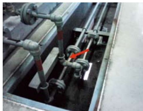
写真2-5-4 発動発電装置 給油管より漏油（矢印部分、ピット内で光って見えるのは漏れた油）
