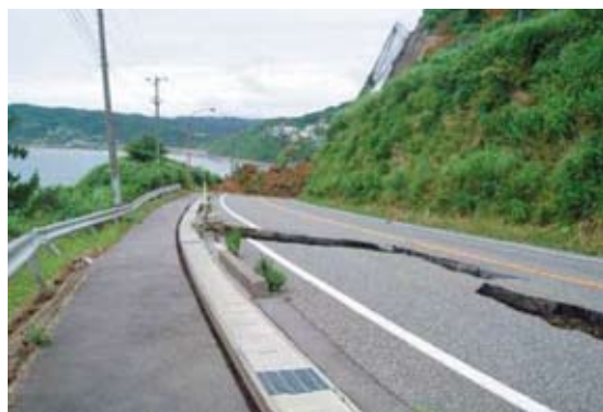
写真3-8-5 陥没した路面
