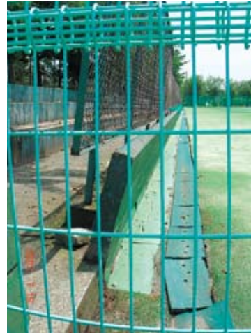
写真2-3-12 白竜公園 (コンクリート擁壁の破損)
