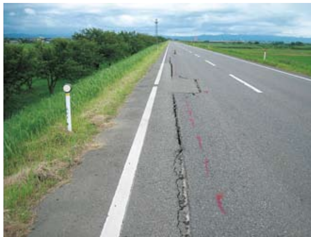
写真2-1-2 地震直後、堤防上面の亀裂
