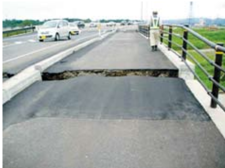
写真4-3-3 歩道に生じた段差
