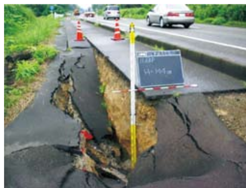
写真2-2-10 歩道沈下(柏崎市西山町田沢)
