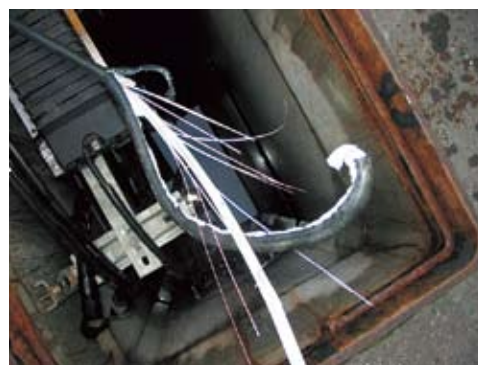
写真2-5-11 破断した光ファイバケーブル(DSF80c)
