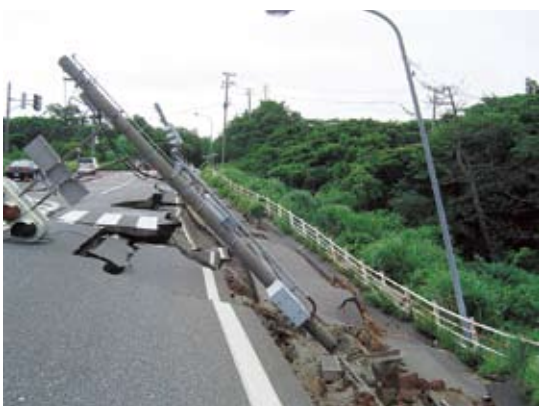
写真2-2-27 被災状況(柏崎市鯨波)
