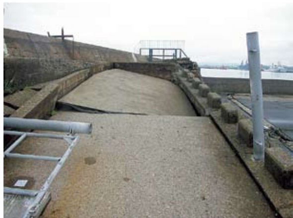
写真3-14-6 西埠頭 西防波堤陥没状況
