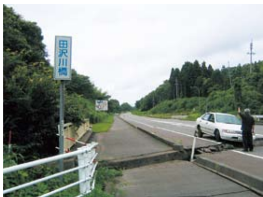
写真2-2-31 被災状況(田沢川橋)
