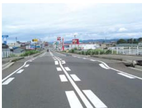
写真2-2-6 路面段差(比角跨線橋)
