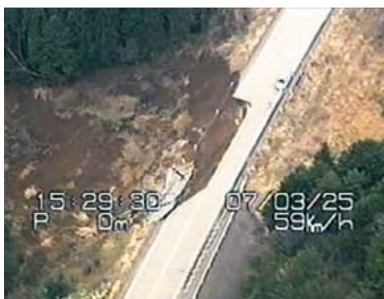
写真7-3-3 きんき号ヘリテレ画像 (能登有料道路豊橋川付近)
