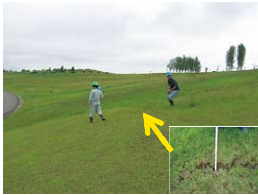
写真2-3-5 フォリーの丘(亀裂(約11m))
