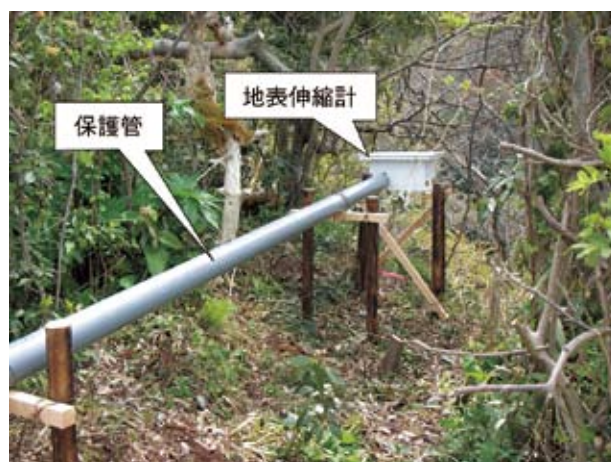
写真2-4 一般的な地表伸縮計の設置状況
