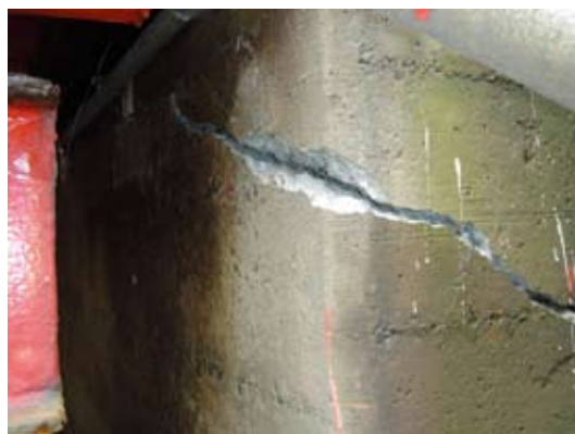
写真4-3-10 橋台パラペット部に生じた亀裂
