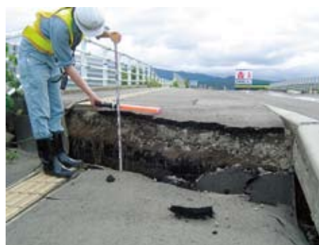
写真4-3-6 歩道に生じた段差
