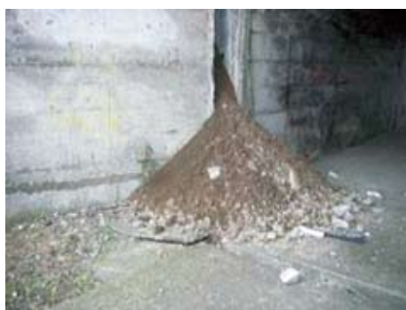
写真4-3-5 橋台と取付擁壁に生じたすき間からの土砂流出
