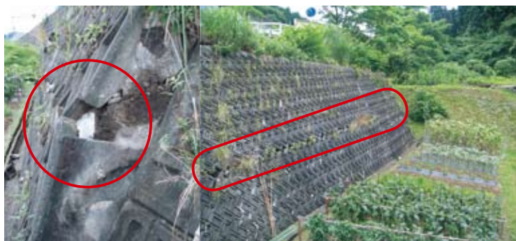
写真4-3-16 オフランプ部ブロック積の破損
