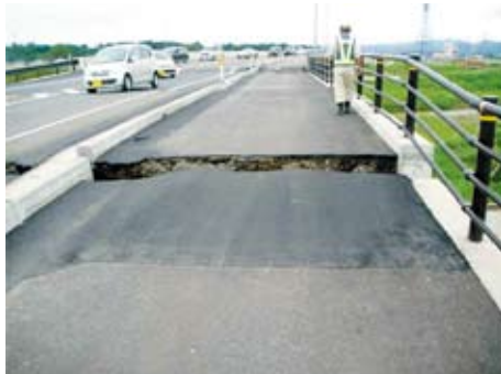
写真4-3-3 歩道に生じた段差
