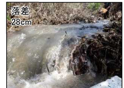
課題②:水路下流部に落差あり
