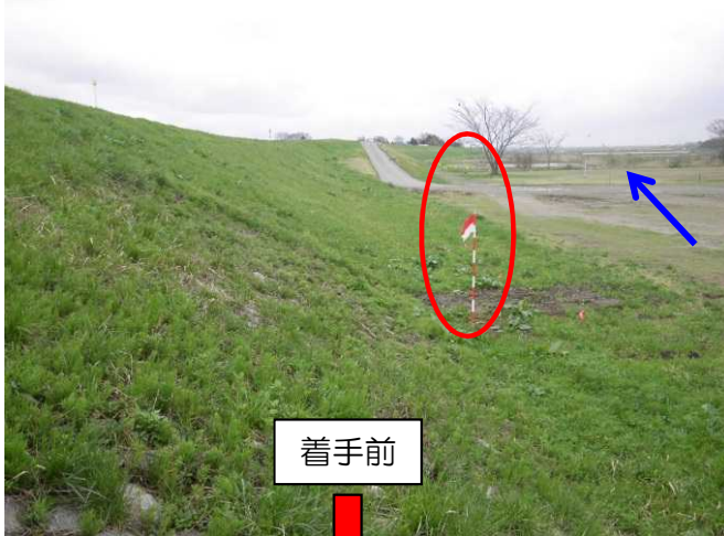
法柳堤防漏水災害復旧工事【堤防基盤漏水 L=350m】 （阿賀野市法柳地先、右岸11.7k付近）
