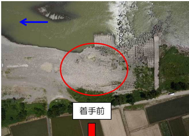
渡場床固及び清瀬護岸災害復旧工事 渡場床固工区【床固護床工流失・根接ぎ欠損 L=65m】 （阿賀野市渡場地先、左岸29.2k付近）
