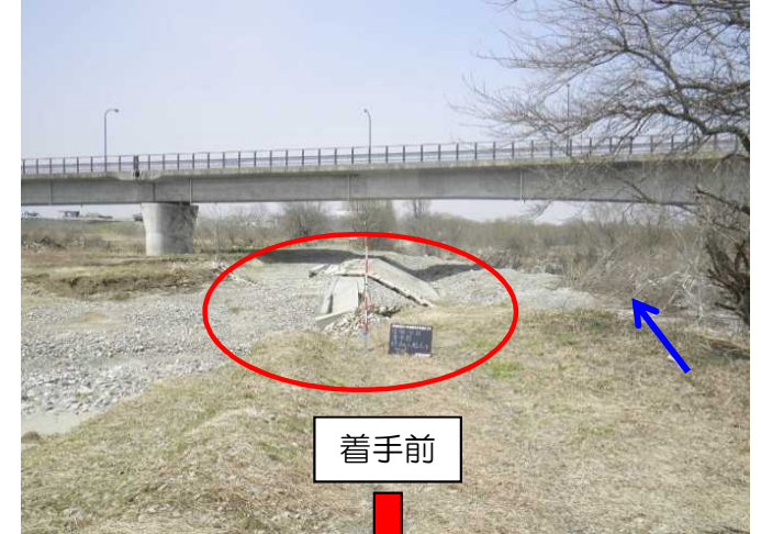
渡場床固及び清瀬護岸災害復旧工事 清瀬工区【低水護岸欠損 L=90m】 （五泉市清瀬地先、左岸28.2k付近）
