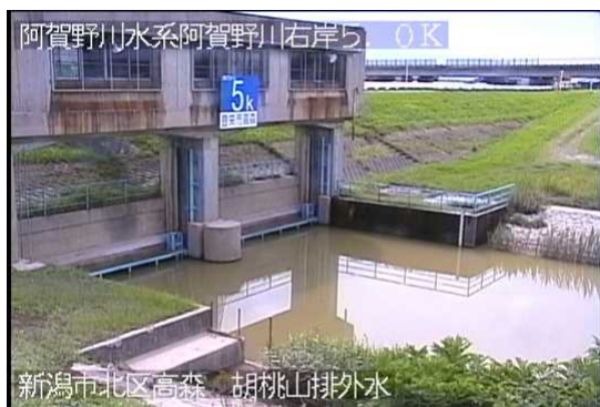
(通常) 胡桃山排水機場休止時は樋門全閉
