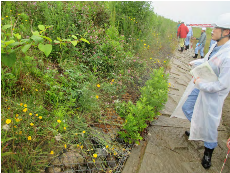
堤防法面 小動物と思われる穴から土砂流出 (左岸・写真中央)新潟市東区 新潟空港付近
