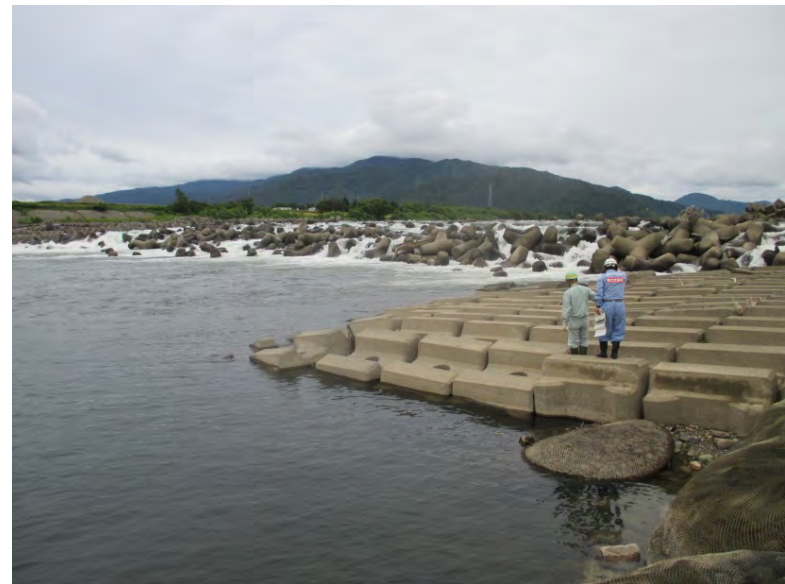
渡場床固 異形ブロック 出水による移動 (左岸・写真奥)阿賀野市渡場付近
