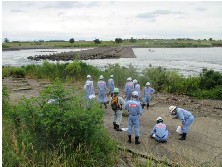
沢海第一床固 平張コンクリート クラック(ひび割れ) (右岸・写真手前)新潟市秋葉区満願寺付近
