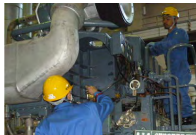
胡桃山排水機場 ポンプ点検
