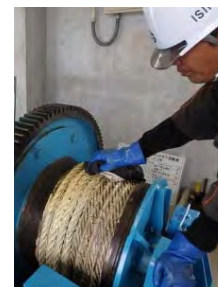
樋門ゲート ワイヤーロープ グリスアップ
