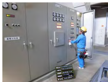
胡桃山排水機場 制御盤点検
