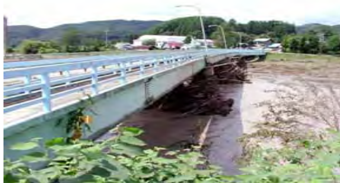
写真 流木の堆積による貫気別橋（歩道橋）の傾斜状況（沙流川水系） ※3
