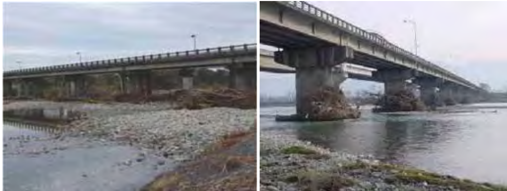
写真 流木の橋脚への堆積（平成16年洪水）（阿賀川） ※1
