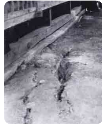
昭和33年頃引牧地区の住居軒下の開口亀裂移転を余儀なくされた
