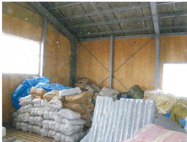
水防倉庫修繕前
