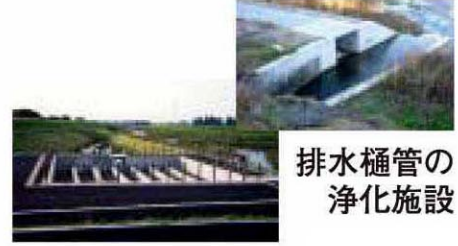
木炭浄化施設
