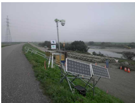
監視カメラ設置
