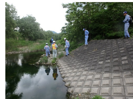
低水護岸元付部の損壊
