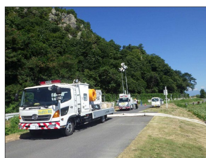
排水ホース配管
