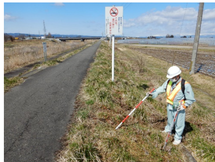
堤防法面の水みち
