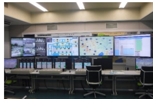
ダム管理用制御処理設備
