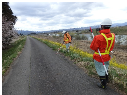
堤防天端舗装損傷
