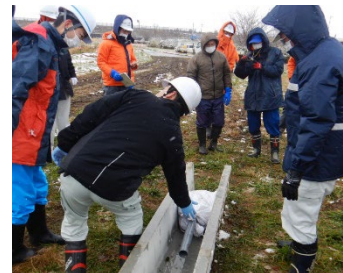
側溝での油流出止め
