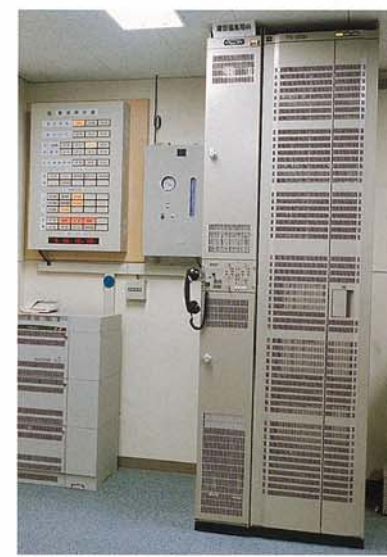
▲警報表示盤・多重無線装置
