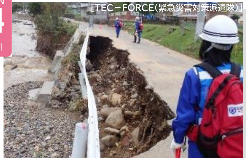
〔令和元年東日本台風 被災状況調査〕
